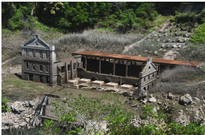
一部崩壊後の曾木発電所遺構（2025年4月撮影）
